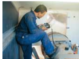
設備診断機器(マシンチェッカー)による点検作業
