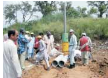
イスラマバードごみ処理場における排水管、ガス抜き管の建設風景
