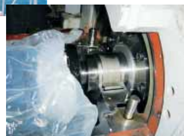
故障診断中の スリーブ軸受
