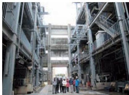
第8回研修風景: 滋賀県湖南中部 浄化センター 污泥スラグ化施設
