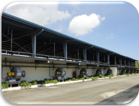
写真 5-152 各槽にエアレーション設備が付随
